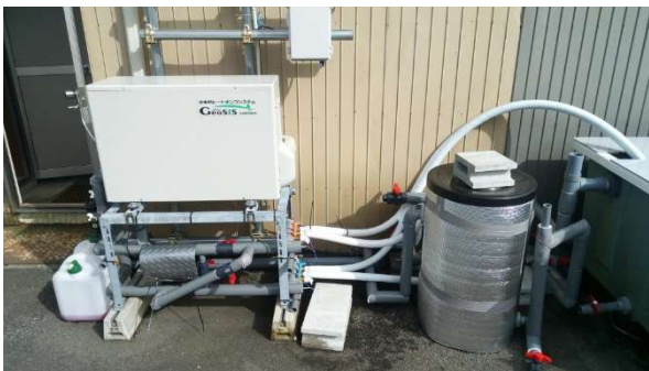
ヒートポンプ室外機・熱交換器
